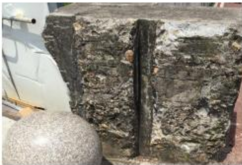
3#旱闸闸墩砼破损
