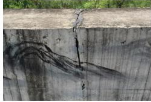
局部防浪墙裂缝
