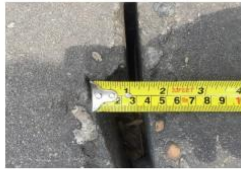
防浪墙局部开裂
