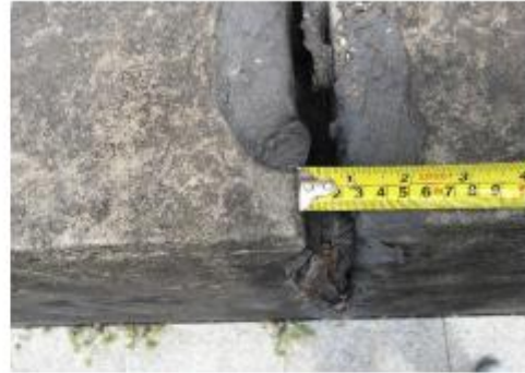
防浪墙局部开裂
