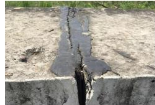
局部防浪墙填缝材料流失
