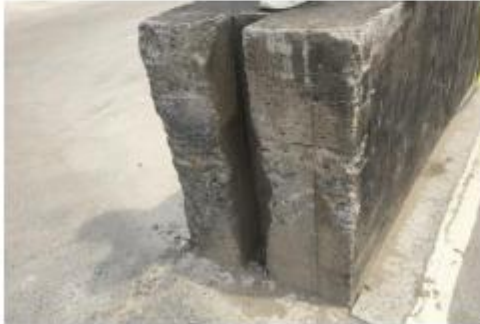
7#旱闸门槽破损
