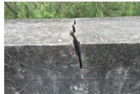
防浪墙局部开裂
